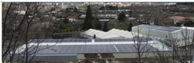
Instalaciones fotovoltaicas en Club Natación Pamplona
